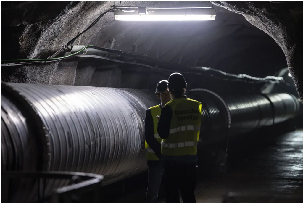
Diese Gas-Pipeline in Urweid bei Innertkirchen transportiert Erdgas durch die Schweiz. Peter Schneider / Keystone
