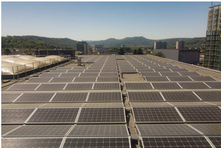
Solarpanels auf dem Dach des Hallerbaus neben dem FHNW-Campus (Bild: zVg)
