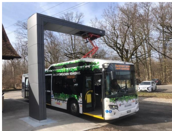
(Pantograf auf der Baldegg für die neuen E-Busse der RVBW)
