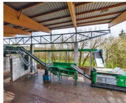
Aufbereitungslinie in Kleindöttingen mit Sternsieb
